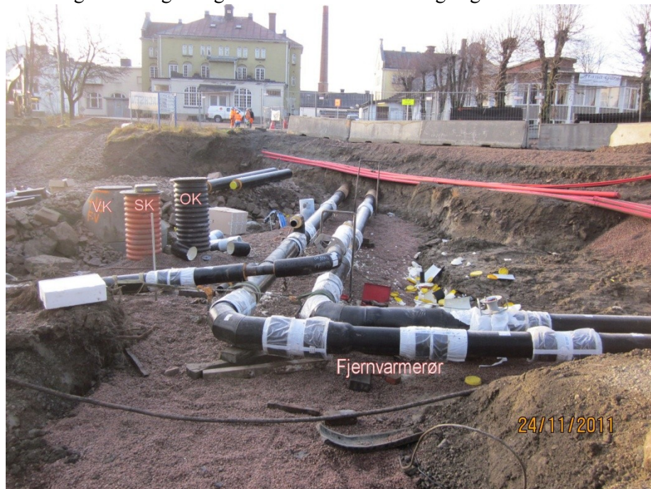
Figur 39 Fjernvarmerør (foto: Terje Rønneberg)
