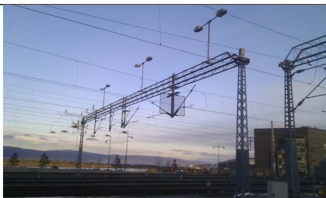
Figur 15 Åk, forankra i to master (B-mast på bortre side, H-mast nærmest). Foto: JBV/Håvard Moe
