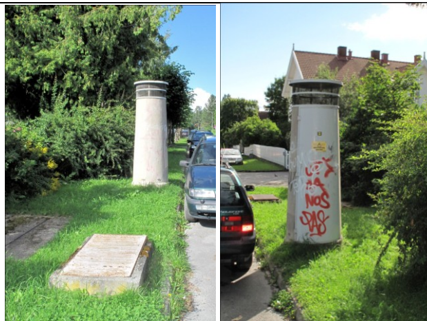
Figur 18 NettverksstasjonAdkomst til underjordisk trafostasjon. Foto: Svein Arne Rakstang, Eidsiva Energi
