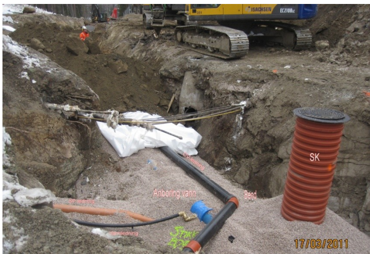
Figur 22 Vannledning med an boring. Foto: Terje Rønneberg
