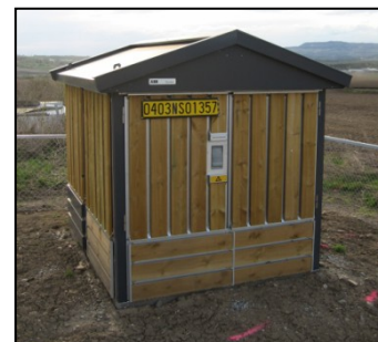
Figur 4 Eksempel på driftsmerking av nettverkstasjon. (Kilde: FKB)
