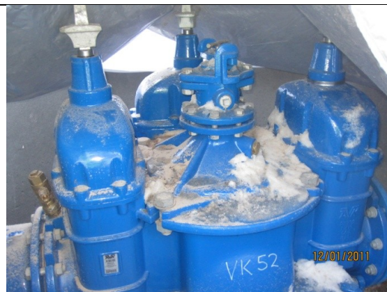
Figur 32 VA-kryss. Foto: Terje Rønneberg
